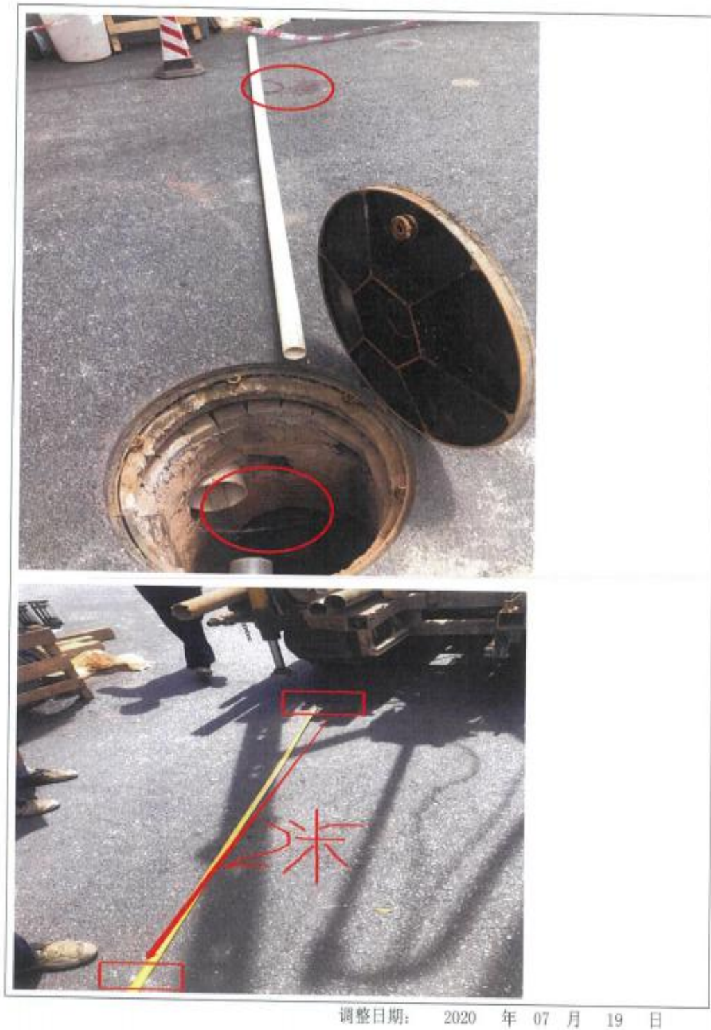
图 3.1.1-4 1B01 点位偏移现场情况
